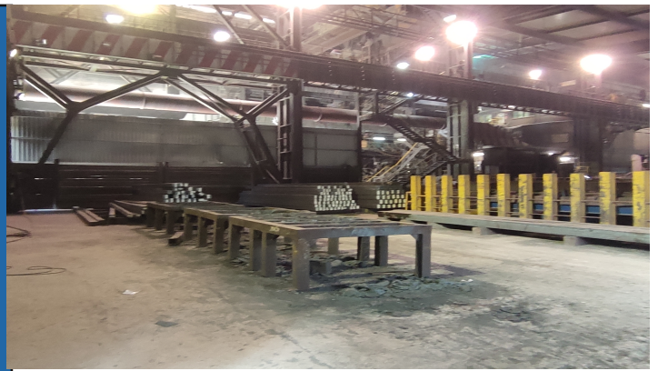
PUERTA 15. Una zona afectada por el estrés térmico en la nave de palanquilla. Se ejecutarán varias mejoras y modificaciones.
