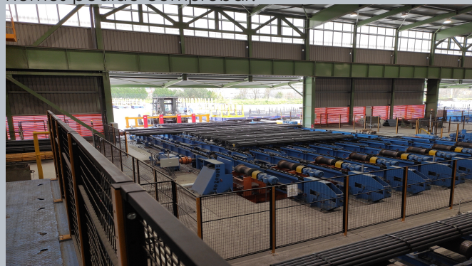
EVACUACIÓN DE LAMINACIÓN. Nuevo sistema de recogida de material para traslado al WIP
